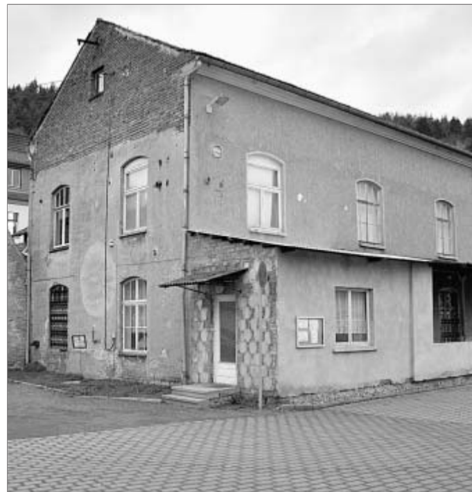
Das Bürgerhaus sieht nicht nur heruntergekommen aus. Die Sanierung ist dringend notwendig.
